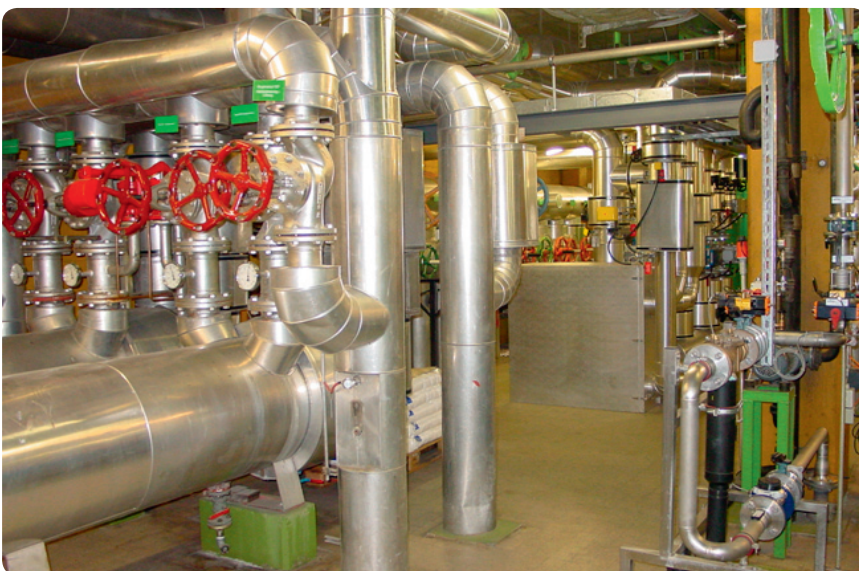
Wärmeverteilung im Kesselhaus
